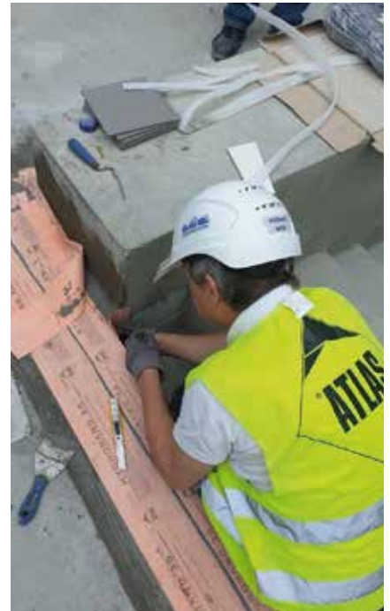
Fot. 5. Wykonanie newralgicznego uszczelnienia pomiędzy niecką basenową a plażami wokółbasenowymi na bazie układu dwóch taśm Hydroband-3G
