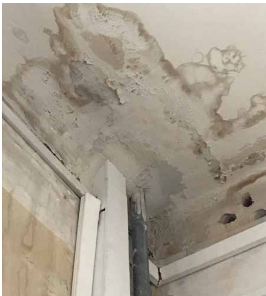
Fot. Zagrzybienie tynków w strefach silnego zawilgocenia ścian – przeciek instalacyjny (fot. J. Szulc)
