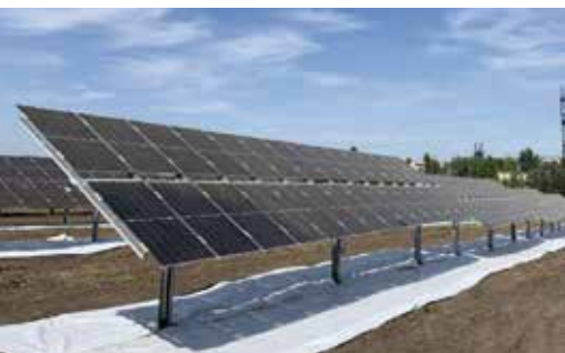
Fot. 4. Przykład instalacji PV z zastosowaną powierzchnią zwiększającą albedo (źródło: https://www.solitek.eu/en/news/solitek-opens-most-advanced-2mw-bifacial-solar-plant-europe )
