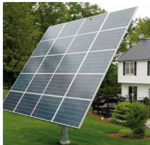
Fot. 3. Mikroinstalacja PV o mocy 4.7 kWp na trackerze (źródło: www.energysage.com/project/6581/allsun-tracker )
